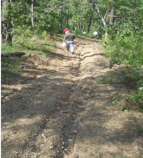
Imagen 6: Proceso de erosión de las vías de transporte
